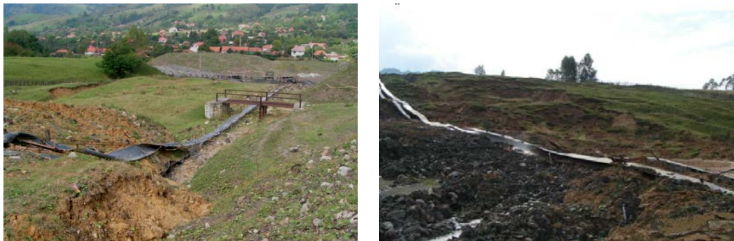
Fig. 3. Fenomene de surpari, ondulari, impingeri si curgeri plastice ale taluzului
