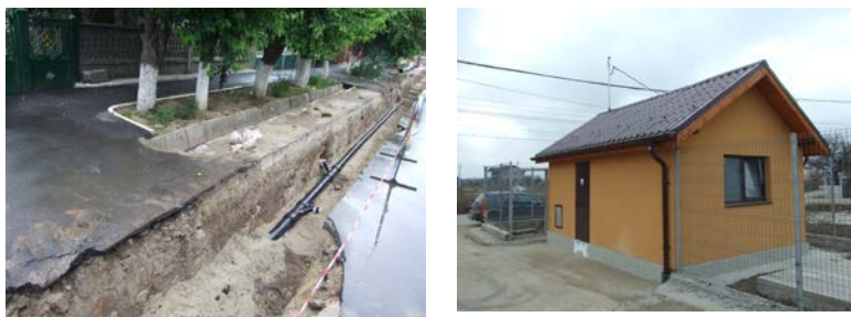
Fig. 5. Sistem de canalizare cu vacuum realizat in Dragomiresti Deal, Ilfov
