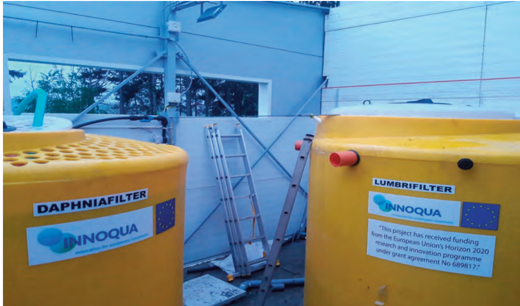
Fig. 2. Instalația sistemului INNOQUA - demo-site România, Iliești, Suceava
